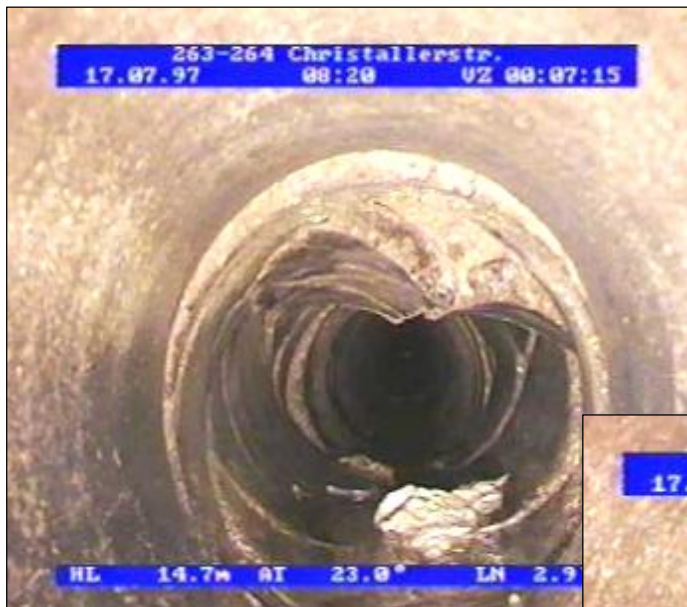
Szkody w kanale przed naprawą
